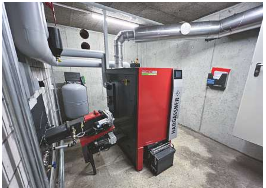
Neue Heizung der Marke «Hargassner» mit Schnitzelzuführung links.
