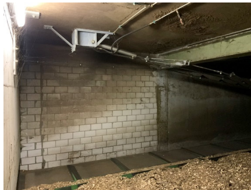
Schnitzelsilo mit Verteilrechen (oben) und Kratzboden (unten)
